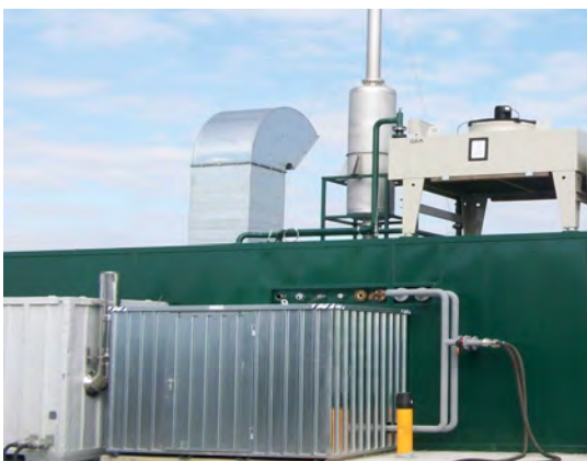
BHKW mit Heizungsverteilersystem
