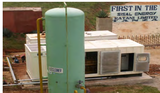
BHKW (2x) und H 2 S Wäsche
