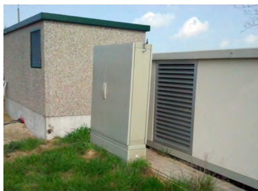
Trafo u. Strom-übergabestation
