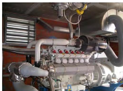
BHKW mit 370 kW el Leistung
