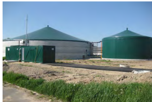
BHKW Container im Vordergrund
