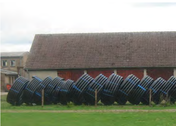
Wärmeheizungsrohre vor der Installation
